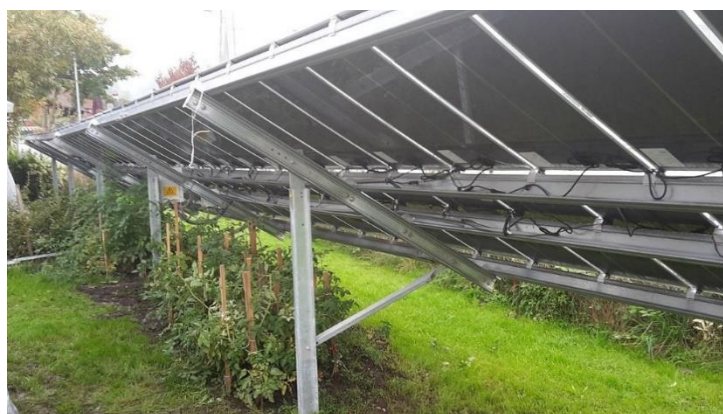
Uprawa pomidorów, pod panelami fotowoltaicznymi
