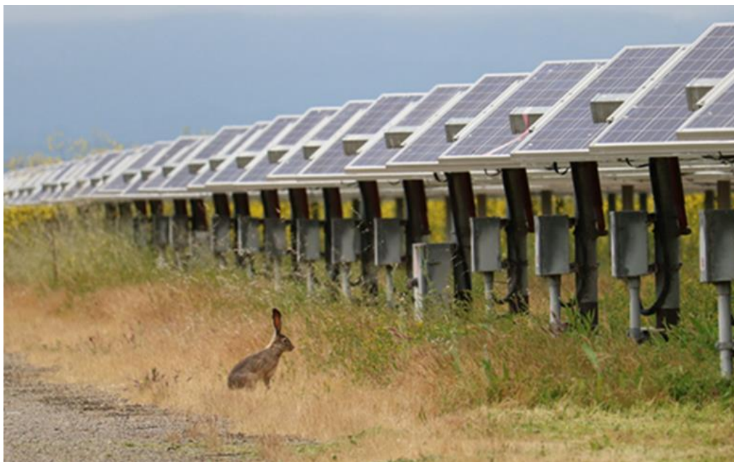
Fot. 1 Odpowiednio wykonane ogrodzenie farmy fotowoltaicznej zapewnia możliwość migracji i żerowania małym i średnim zwierzętom (Źródło: https://www.rpcs.com/wp-content/uploads/2019/03/Solar-and-Wildlife_RPCS.pdf )
