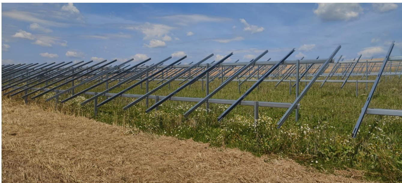
Zdjęcie 2 Konstrukcja przeznaczona do posadowienia paneli fotowoltaicznych.
