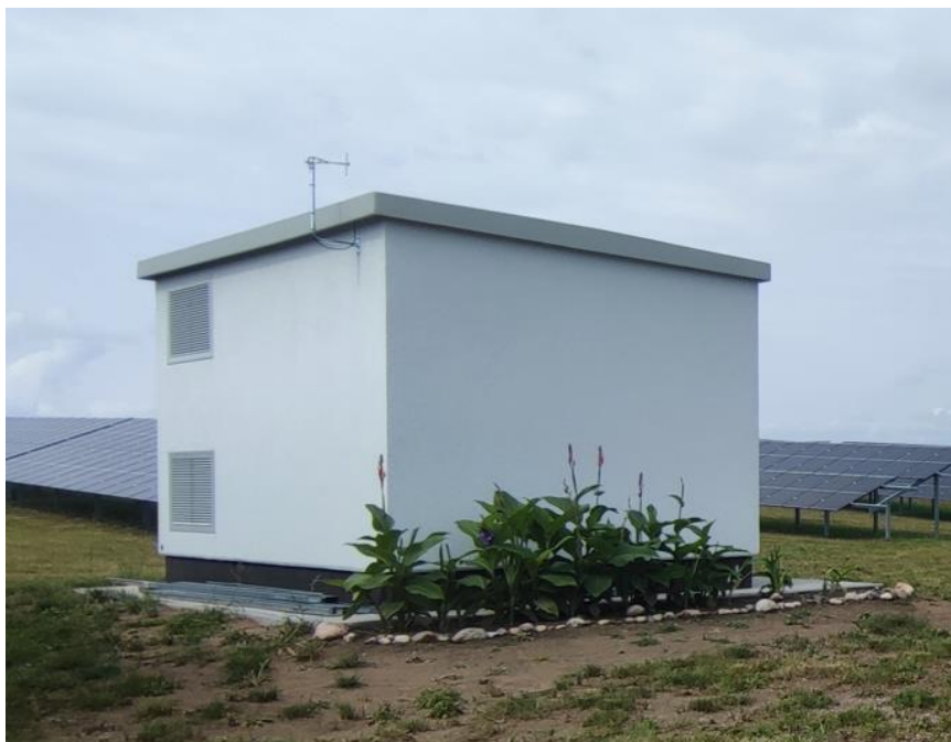
Zdjęcie 8 Kontenerowa stacja transformatorowo-rozdzielcza
