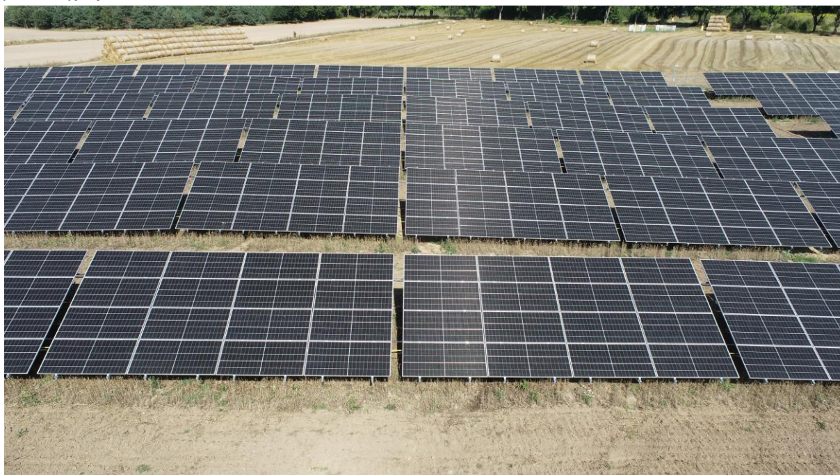
Zdjęcie 3 Przykładowe moduły fotowoltaiczne.
