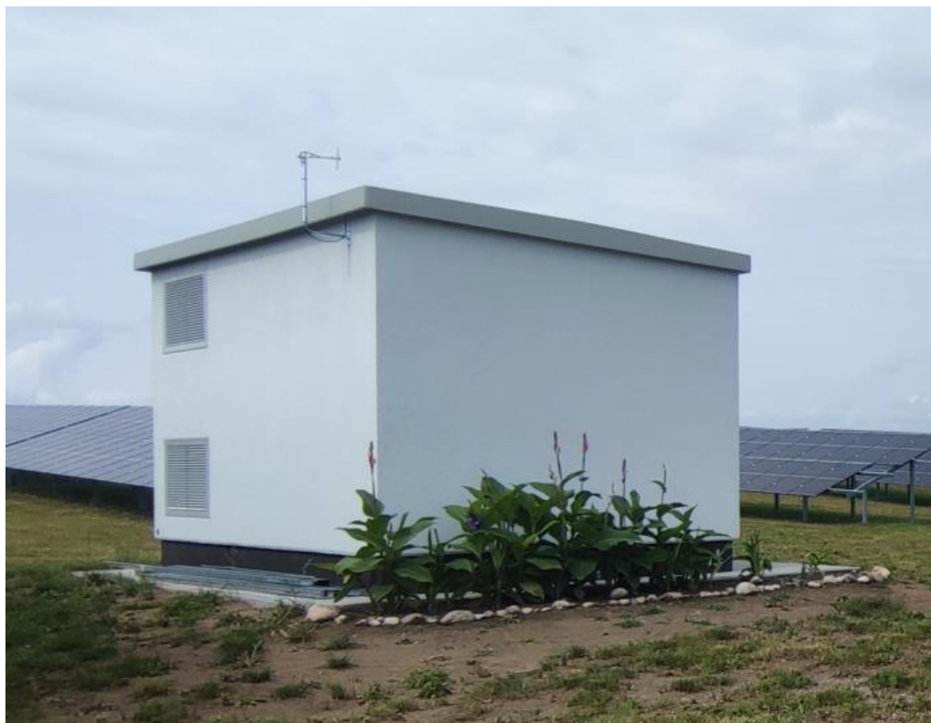
Zdjęcie 5 Przykładowa stacja transformatorowa.
