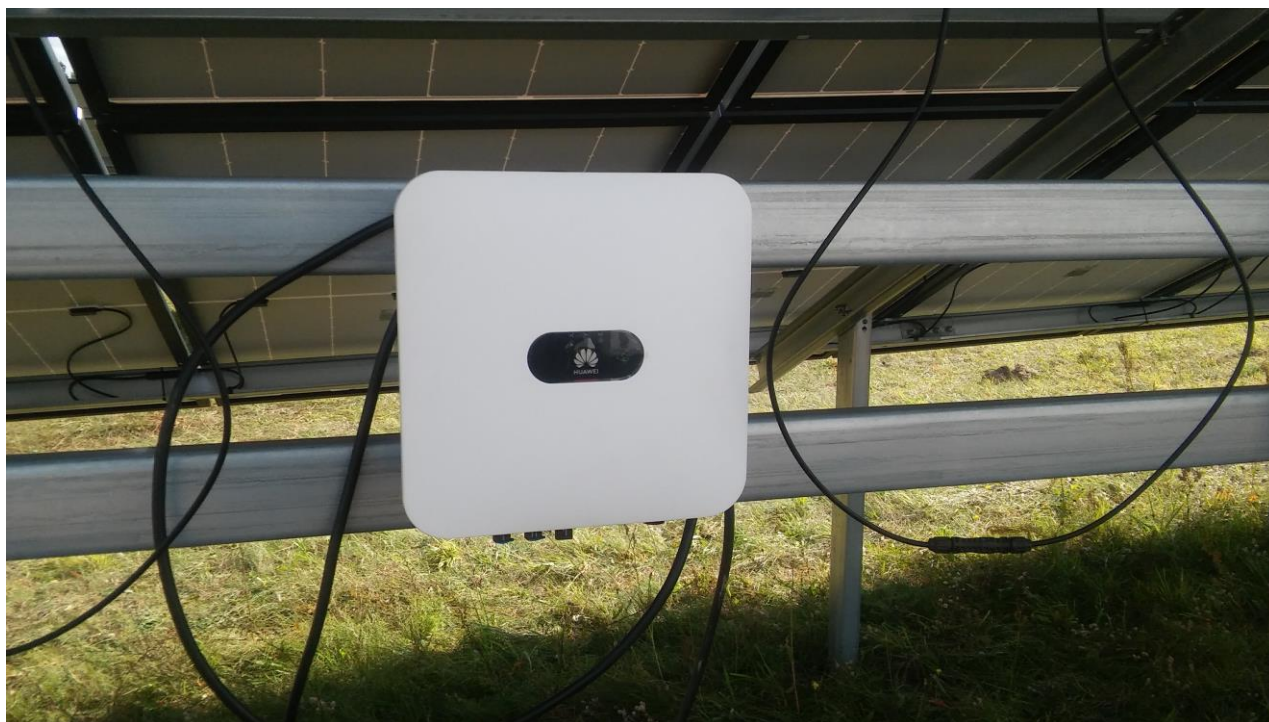
Zdjęcie 4 Przykładowy inwerter farmy fotowoltaicznej.
