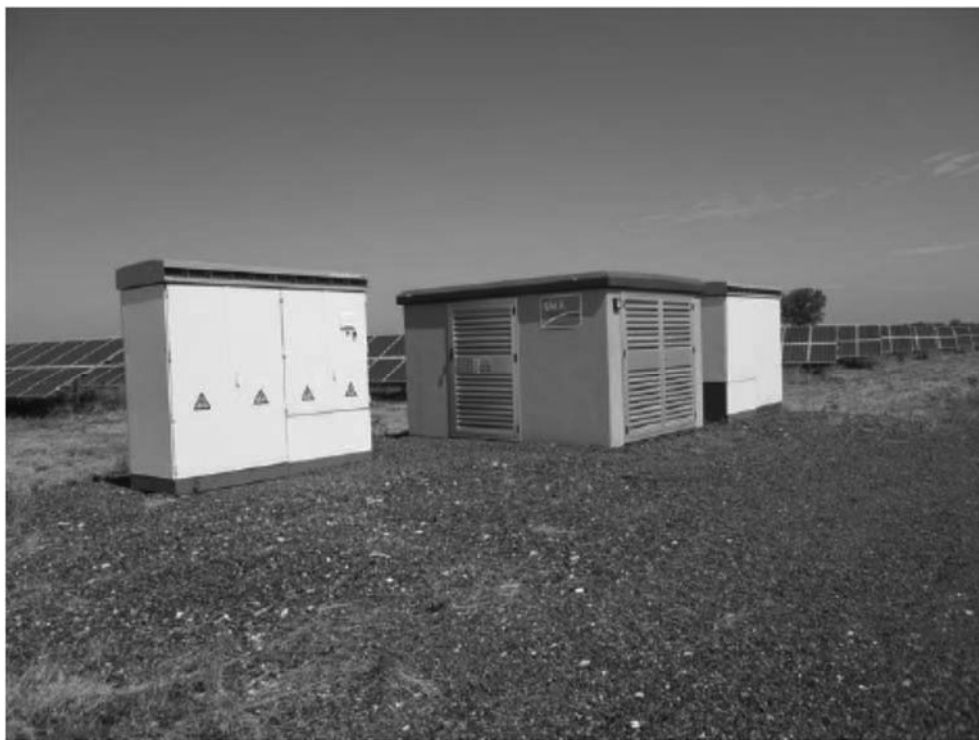
Zdjęcie nr 8. Obudowa inwertera w postaci wolnostojącej szafy (biały obiekt po lewej stronie zdjęcia) oraz stacja transformatora (szary obiekt w centralnym miejscu zdjęcia).
