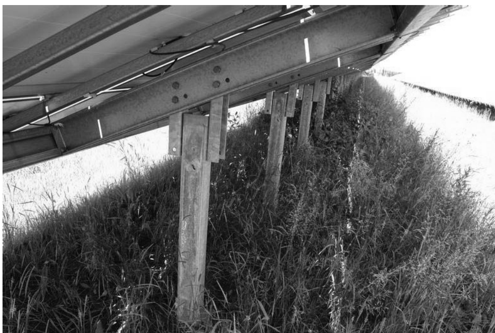
Zdjęcie nr 5. Widoczny sposób łączenia szkieletu - podstawy modułów fotowoltaicznych z profilami.
