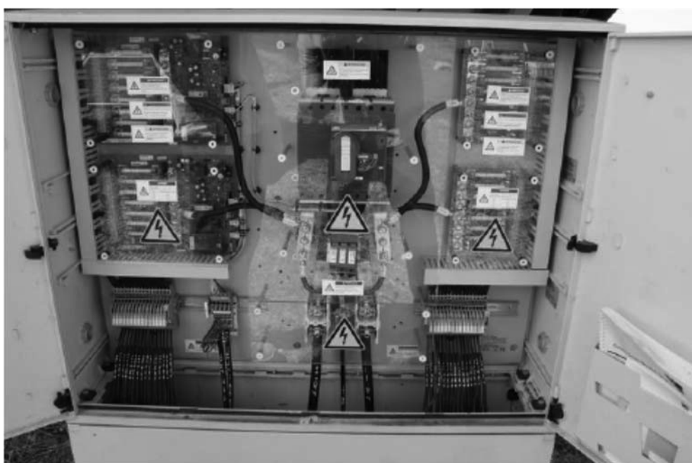
Zdjęcie nr 7. Wnętrze string-box`a.
