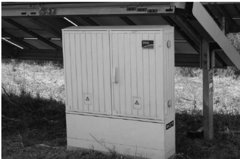
Zdjęcie nr 6. String-box mocowany na gruncie.
