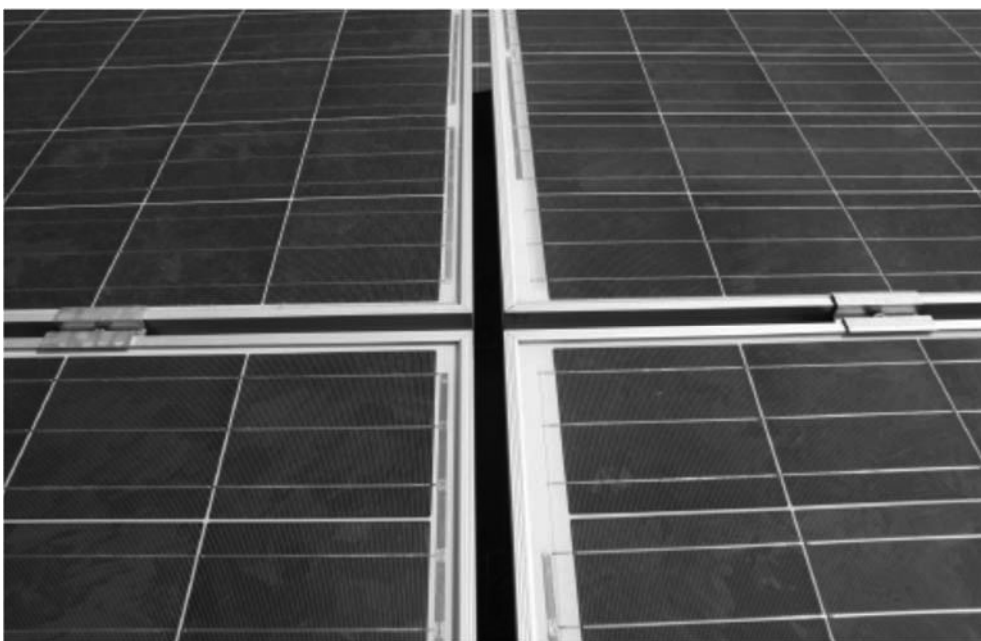
Zdjęcie nr 3. Widoczny sposób wzajemnego ułożenia poszczególnych modułów fotowoltaicznych.
