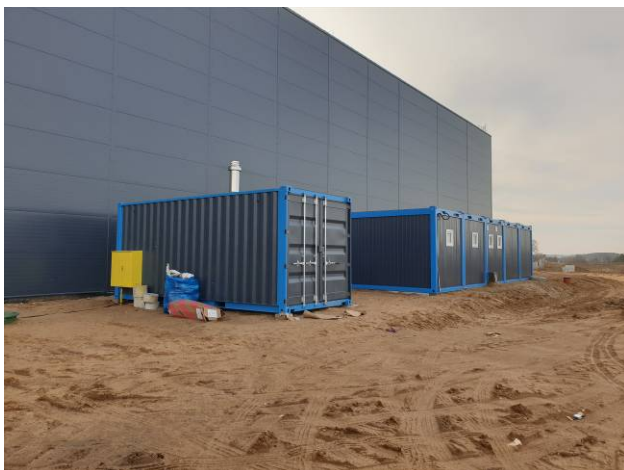
Fot. 9 Kotłownia oraz kontenery sojalne przy hali nr 1.
