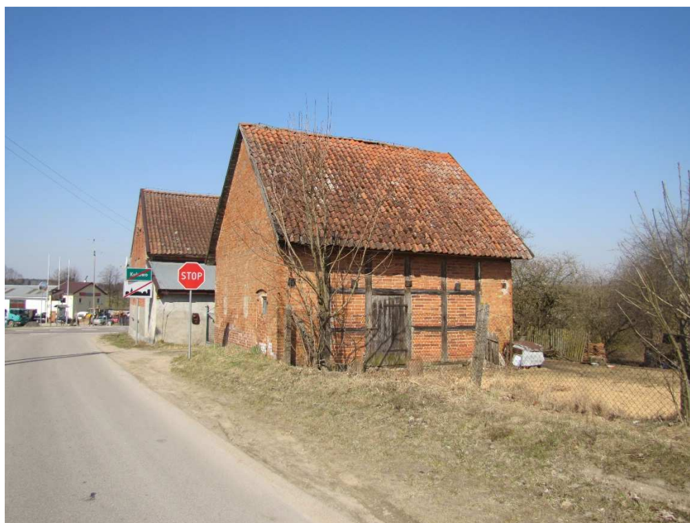
Fot. 4. Budynek gospodarczy w m. Kukowo przeznaczony do rozbiórki, km 43+750 drogi krajowej nr 65 (M. Jastrzębska-Milewska, 2018).
